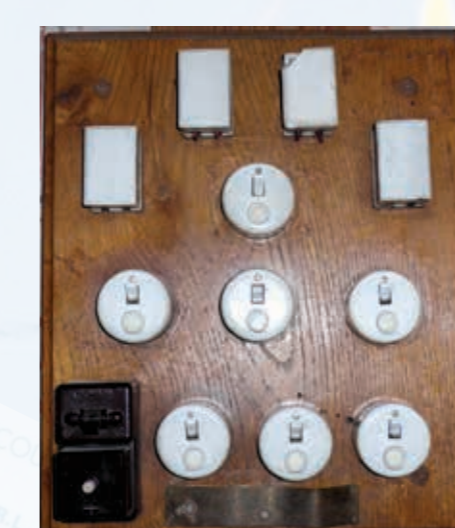
Ci-dessus, une électricité architecturale équipe la chapelle.
